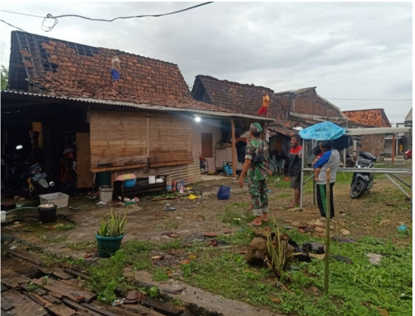
Babinsa Koramil 13/Karangawen Cek Rumah Rusak Akibat Puting Beliung
